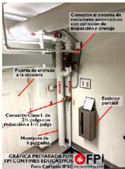
Figura 2 - Montante de agua con conexión Clase I y conexión al sistema de rociadores automáticos
